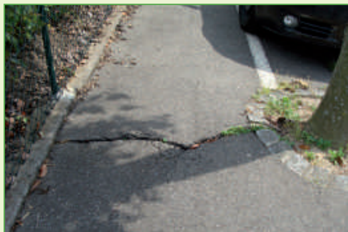
Trottoir abimé par les racines des arbres, rue des Hêtres
