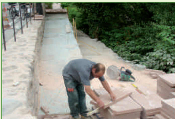
Création d'un plan incliné en zigzag pour accéder aux berges de la Weiss (rue Basse du Rempart)
