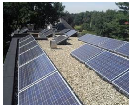
Non intégré au bâti
